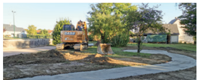
Septembre 2021 • Jardin derrière la Salle des Fêtes
